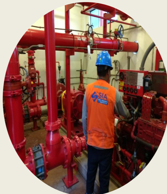
Instalaciones de Sistemas Contra Incendio
