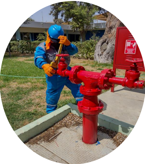
Sistemas Contra Incendio
